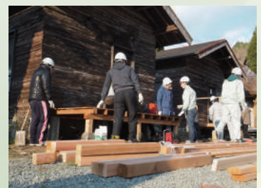
建設マネジメント演習及び実習におけるウッドデッキ施工
