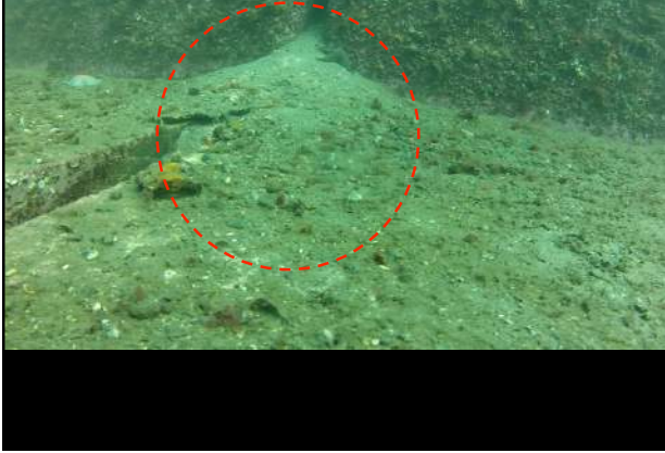
日吉原コンテナターミナル
